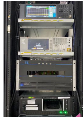
图9 终端系统安装在机架
